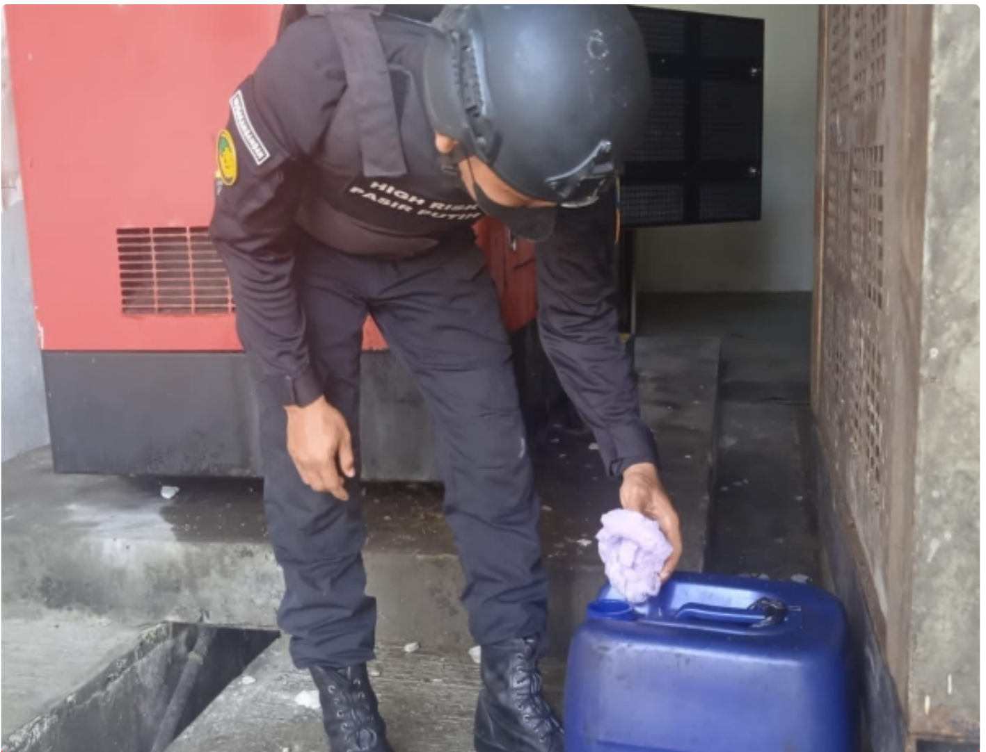
Petugas Lapas Pasir Putih melaksanakan pengecekan bahan bakar solar untuk mesin genset
